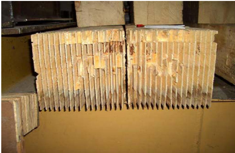
Bild 5: Keilzinkenverbindung eines Untergurtes (auseinandergeklappt) - es ist deutlich zu erkennen, dass das untere Viertel der Leimflächen ohne Wirkung war
