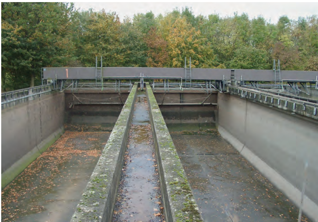
Abb. 3.1.1.3-1 Regenüberlaufbecken Hamm-Mattenbecke (Foto: StUA Lippstadt)
