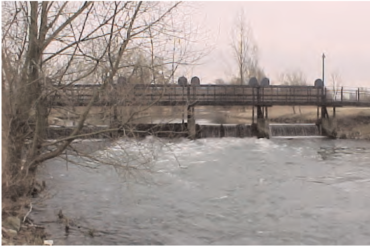
Abb. 3.1.4-5 Lippewehr zur Ableitung in den Boker Kanal (Foto: Ing.-Büro Floecksmühle, Aachen)
