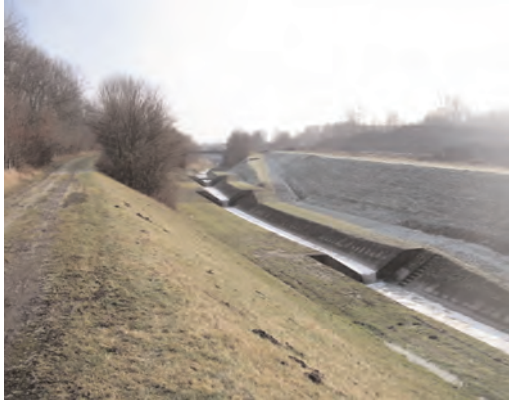
Abb. 3.1.5-2 Bergbaugeschädigter eingedeichter Kuhbach - offener Schmutzwasserlauf - in Bergkamen (Foto: StUA Lippstadt)
