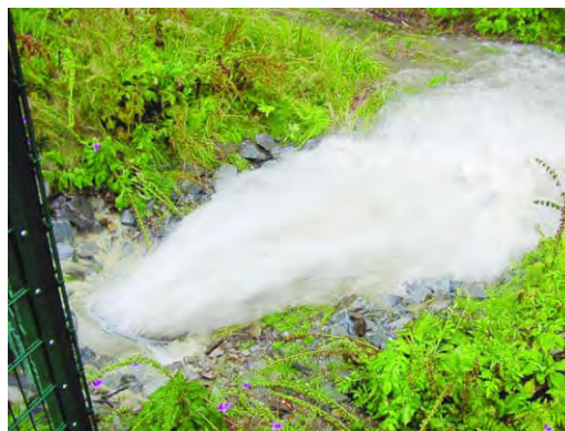
Abb. 3.1.1.4-2 Einleitung aus Regenwasserbehandlungsanlage (Foto: StUA Hagen)
