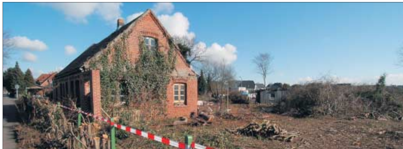
Um dieses Grundstück in Kummerfeld geht es: Nur das ehemalige Wohnhaus von Thea Schädlich steht noch. Ursprünglich war es von Bäumen und Büschen umgeben. Die Gemeinde räumte das Grundstück. Den Abriß des Hauses hat inzwischen ein Gericht vorläufig verboten.
